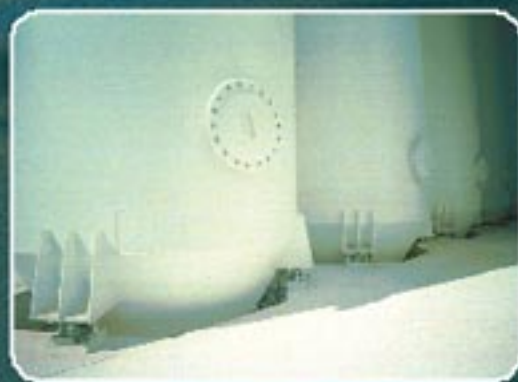
► Batería de silos con células en cada apoyo.
