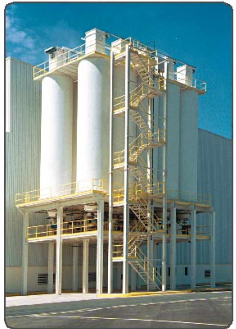
► Silos de distribución.
