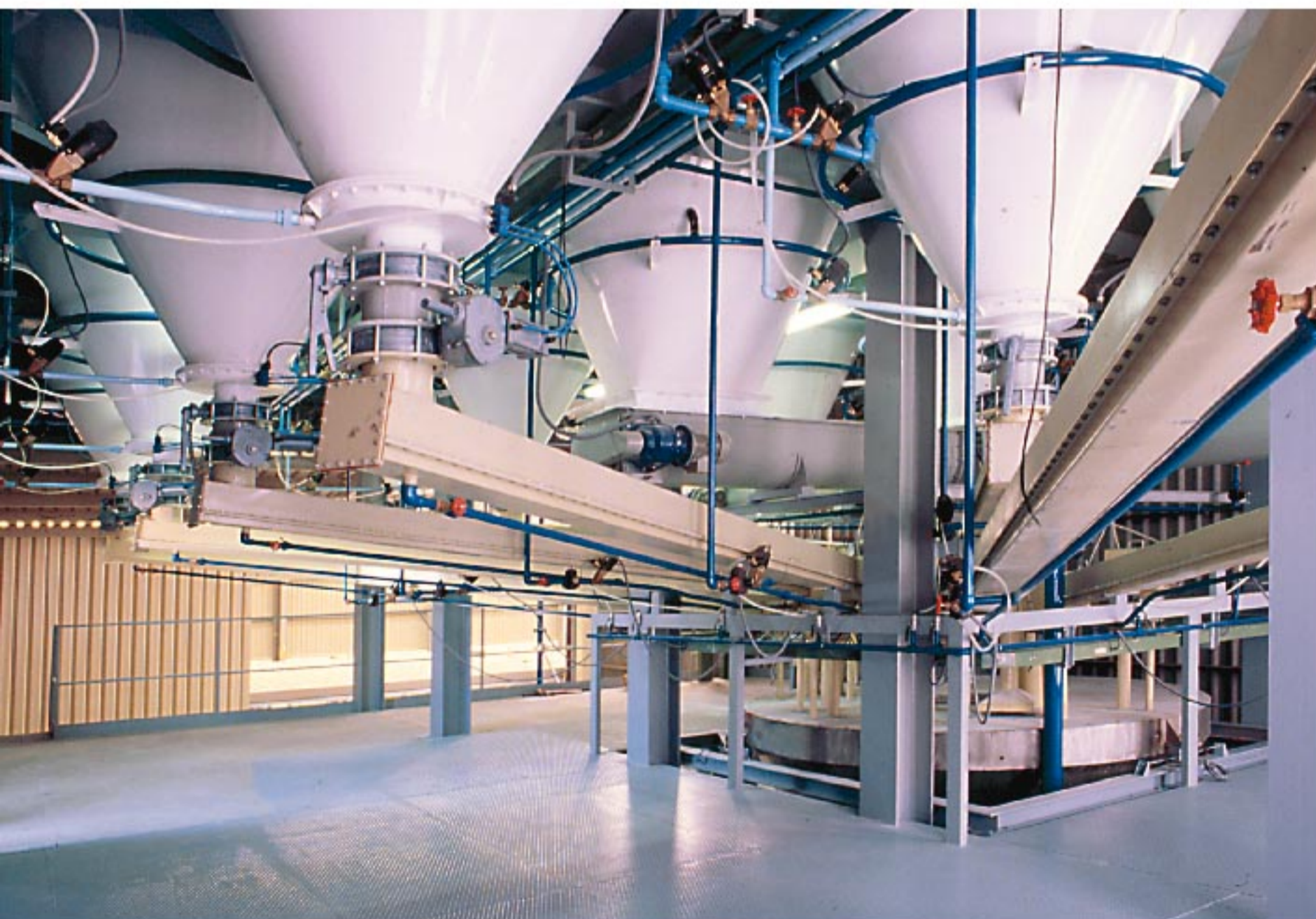
► Dosificación mediante aerodeslizadores y sinfines a Tolva de Pesaje.
