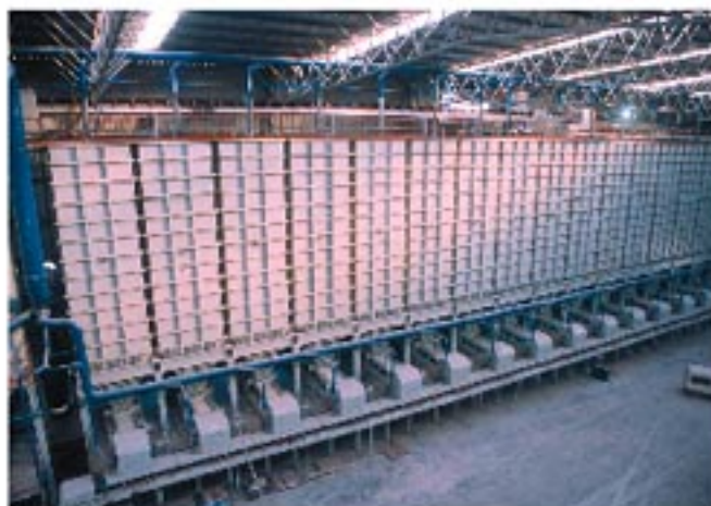
► Batería de silos rectangulares arcilla.
