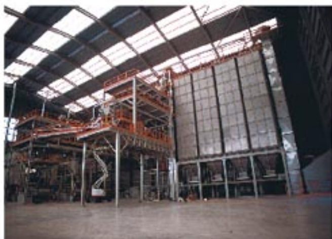
► Batería de silos de acero inoxidable almacenamiento arcilla atomizada por celánica.
