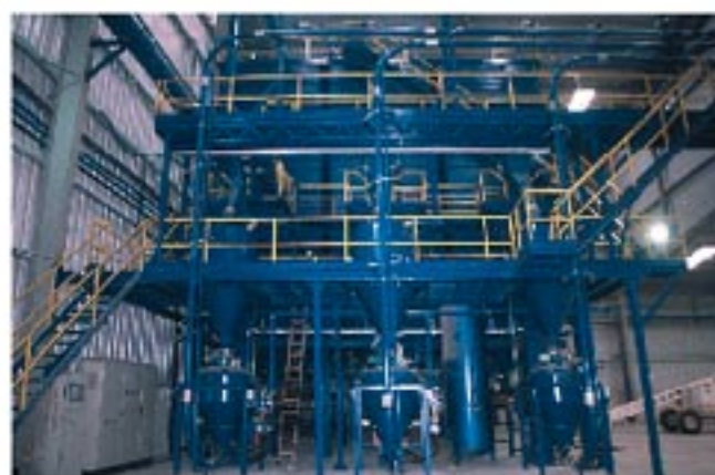
► Vista general propulsores arcilla atomizada.
